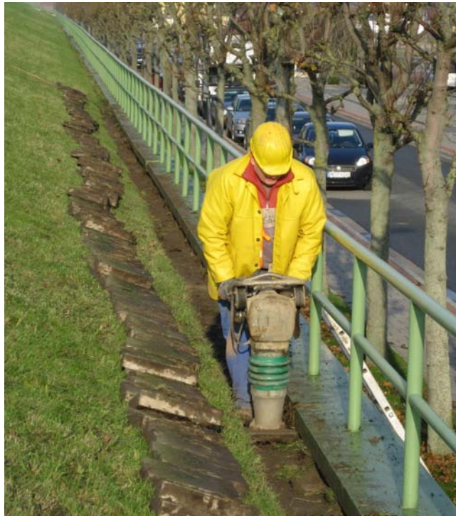
Behebung der Wühltierschäden am Lohmandeich
