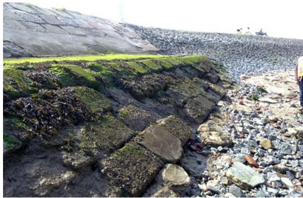
Schäden am Deckwerk des Seedeichs
