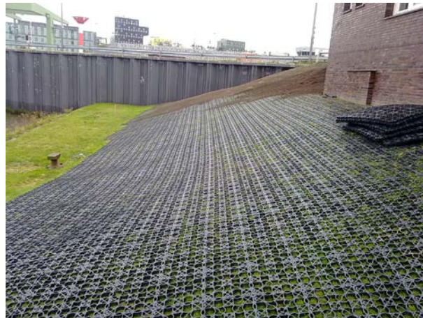
Wühlschutzsysteme im Bereich der Fischereihafenschleuse
