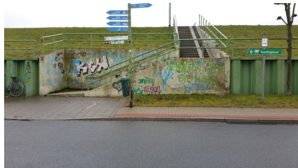
Graffiti am Treppenaufgang Lohmandeich
