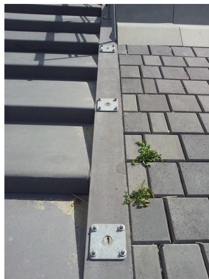
Zerstörtes Geländer am Weserdeich
