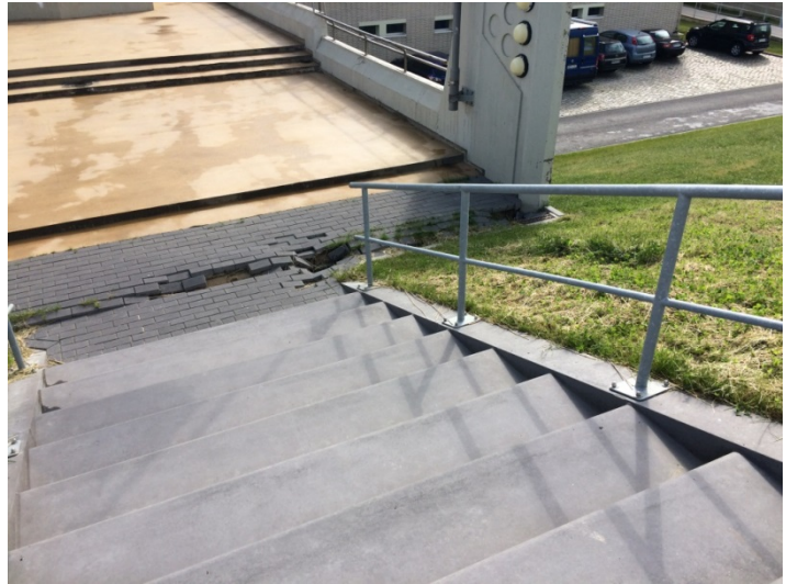
Durch Kaninchen verursachte Schäden am Übergang vom Weserdeich zum Schifffahrtsmuseum
