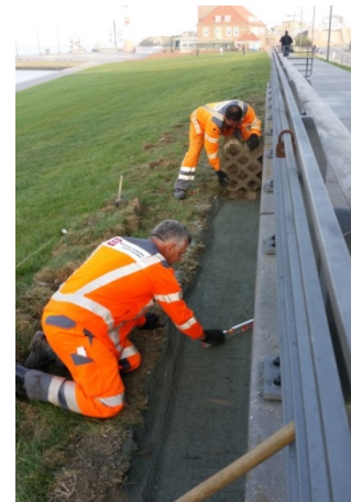
Beseitigung der Hohlräume und Versackungen am Weserdeich
