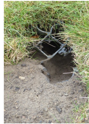
Kaninchenbau an der Fischereihafenschleuse
