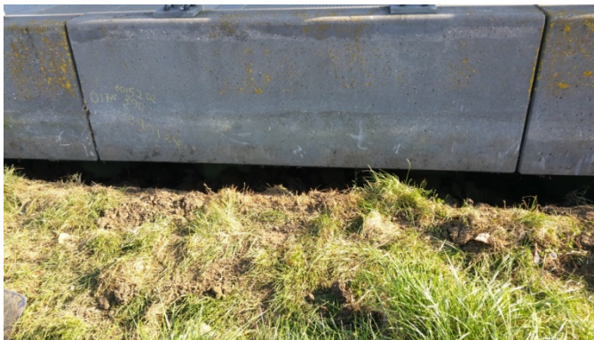
Hohlräume an der Spundwand des Weserdeichs
